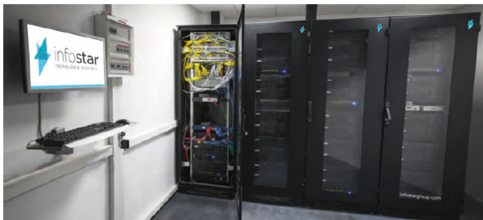
Un data center in locazione operativa installato presso un cliente
